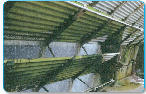
Rückkühler bei Versuchsstart
