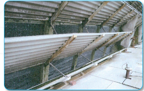
Rückkühler bei Versuchsende
