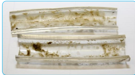
PVC Leitungen mit Biofilm
