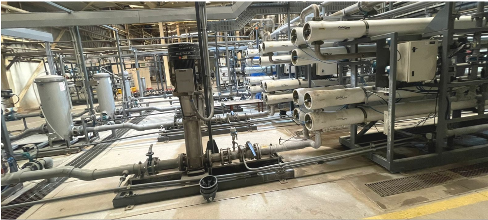
Industrielle Wasseraufbereitungsanlage mit Vorfiltern (links) und Membranfiltern (rechts)
