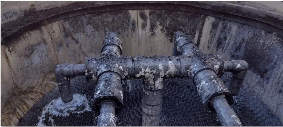
Verdunstungskühlanlage mit starken Kalk- und Schmutzkrusten
