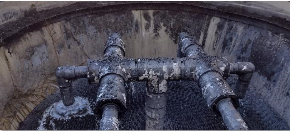
Sistema de enfriamiento por evaporación con importantes incrustaciones de calcio y suciedad
