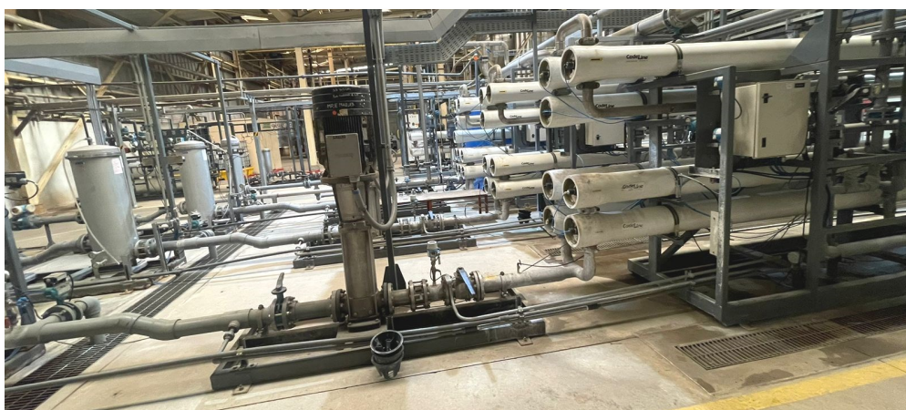
Installation de traitement de l'eau industrielle comprenant des préfiltres (à gauche) et des filtres membranaires (à droite)
